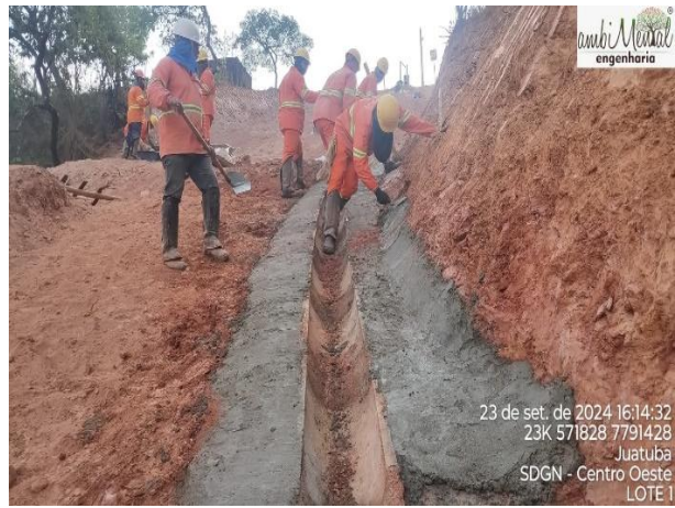
Figura 9 – Construção do sistema de drenagem no trecho 4. Data: 23/09/2024. Coordenadas Geográficas UTM 23 k longitude 5711828 latitude 7791428.
